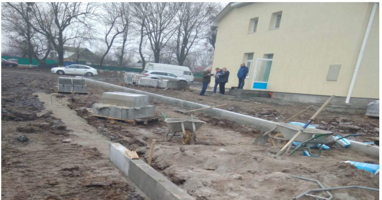
Фото 6. Вигляд місця на території Капустянської амбулаторії загальної практики сімейної медицини, де за актами про виконані роботи мали бути облаштовані ганки, під'їзні шляхи асфальтобетонною сумішшю, зовнішнім освітленням та огорожею
