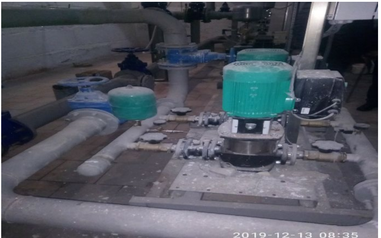
Фото 4. Вигляд місця на території Вінницької обласної клінічної лікарні ім. М.І. Пирогова, де за актами про виконані роботи мала бути встановлена насосна підвищувальна установка з частотним регулюванням вартістю 295,7 тис. гривень
