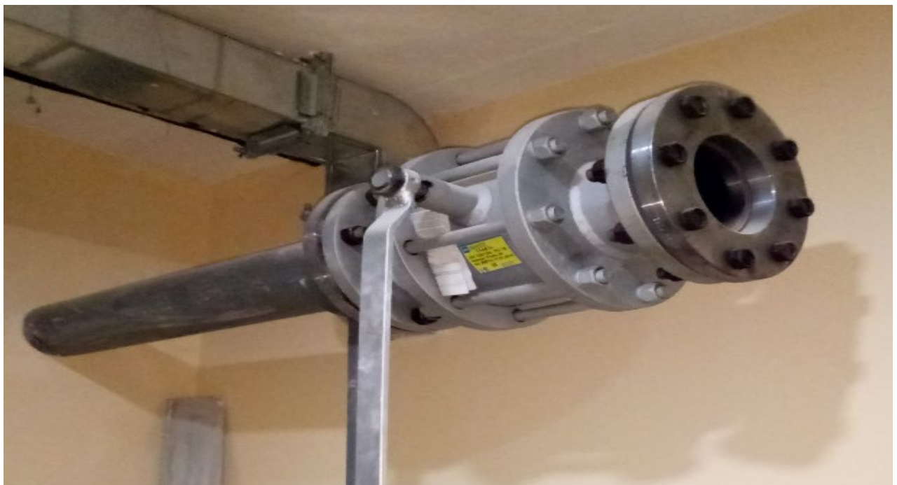
Фото 2. Елементи системи пожежогасіння театру ляльок, які не підключені до насосної станції (відсутня)
