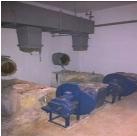
Електро-ручні вентиляторні пристрої, придбані у 2018 році, на момент огляду не змонтовані.
