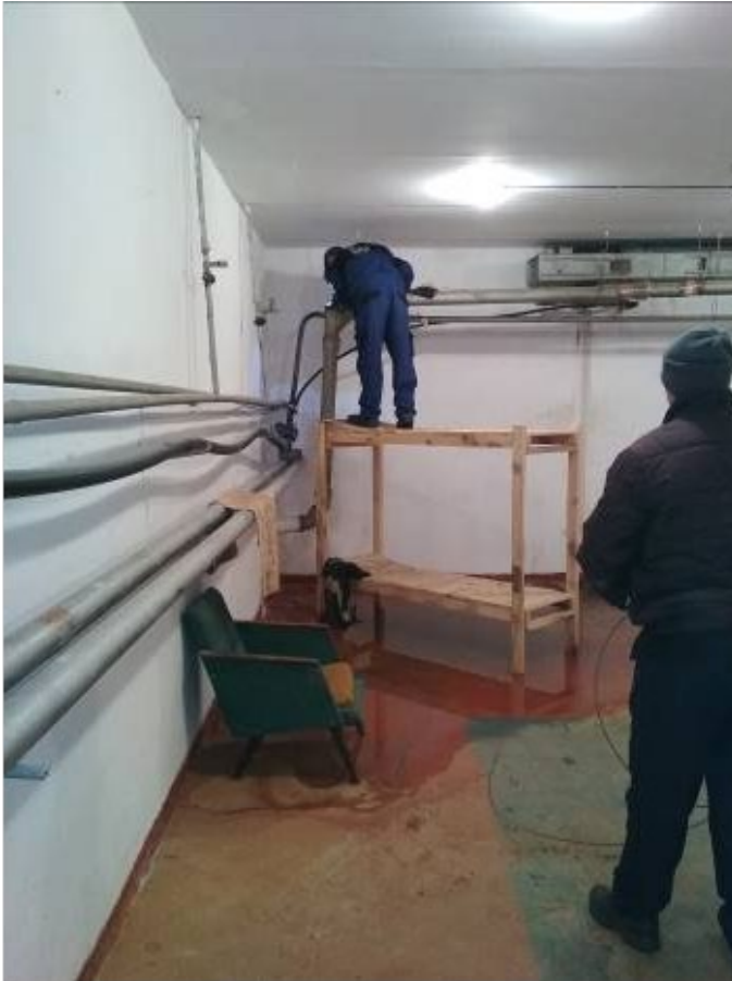
На підлозі наявні застої води (через прориви будинкових комунікацій)
