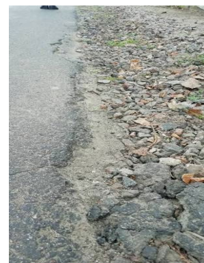
Руйнування країв дорожнього одягу
