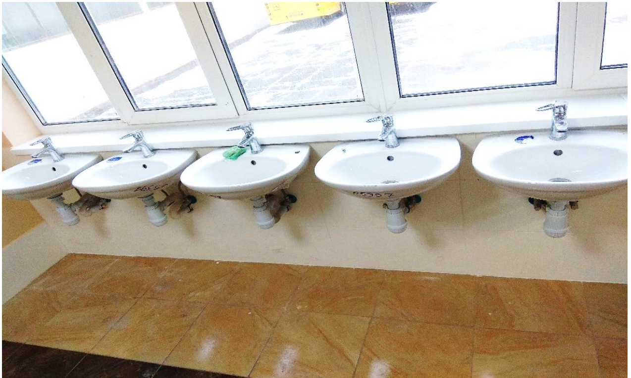
Фото. Умивальники без п'єдесталів, установлені у приміщенні їдальні Вороновицького ліцею Вінницької області (за актами приймання-передачі виконаних робіт оплачені з п'єдесталами). Огляд проведено 14.01.2021
