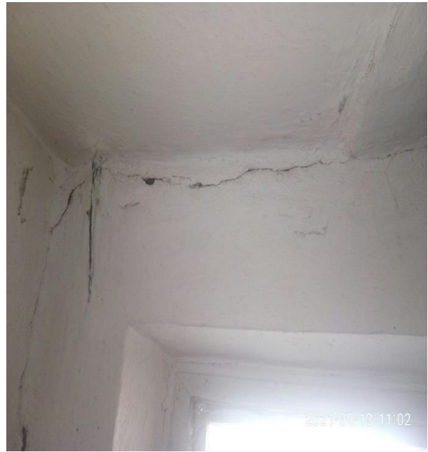
Фото 12. Стіни та стеля в кімнатах, кухні, коридорі глиняні дерев'яно-вальковані, з суцільними тріщинами орієнтовною шириною 0,5-1,0 сантиметри. Ознак ремонту не виявлено.
