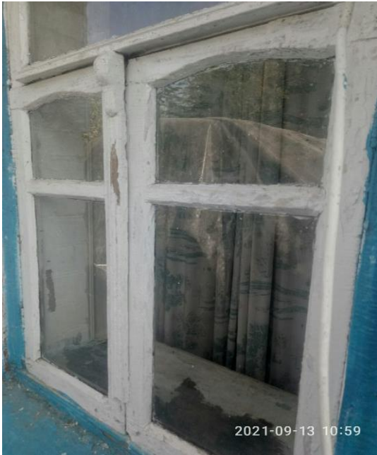
Фото 11. Дерев'яні вікна щільно не закриваються.
